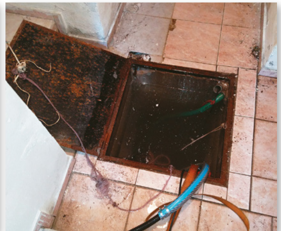
Das Hochwasser hinterließ auch im Haus der Begegnung seine Spuren.
